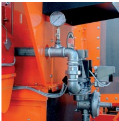
Brûleur à gaz/biogaz à très basses émissions. Qualité garantie des céréales séchées, même de type biologique
